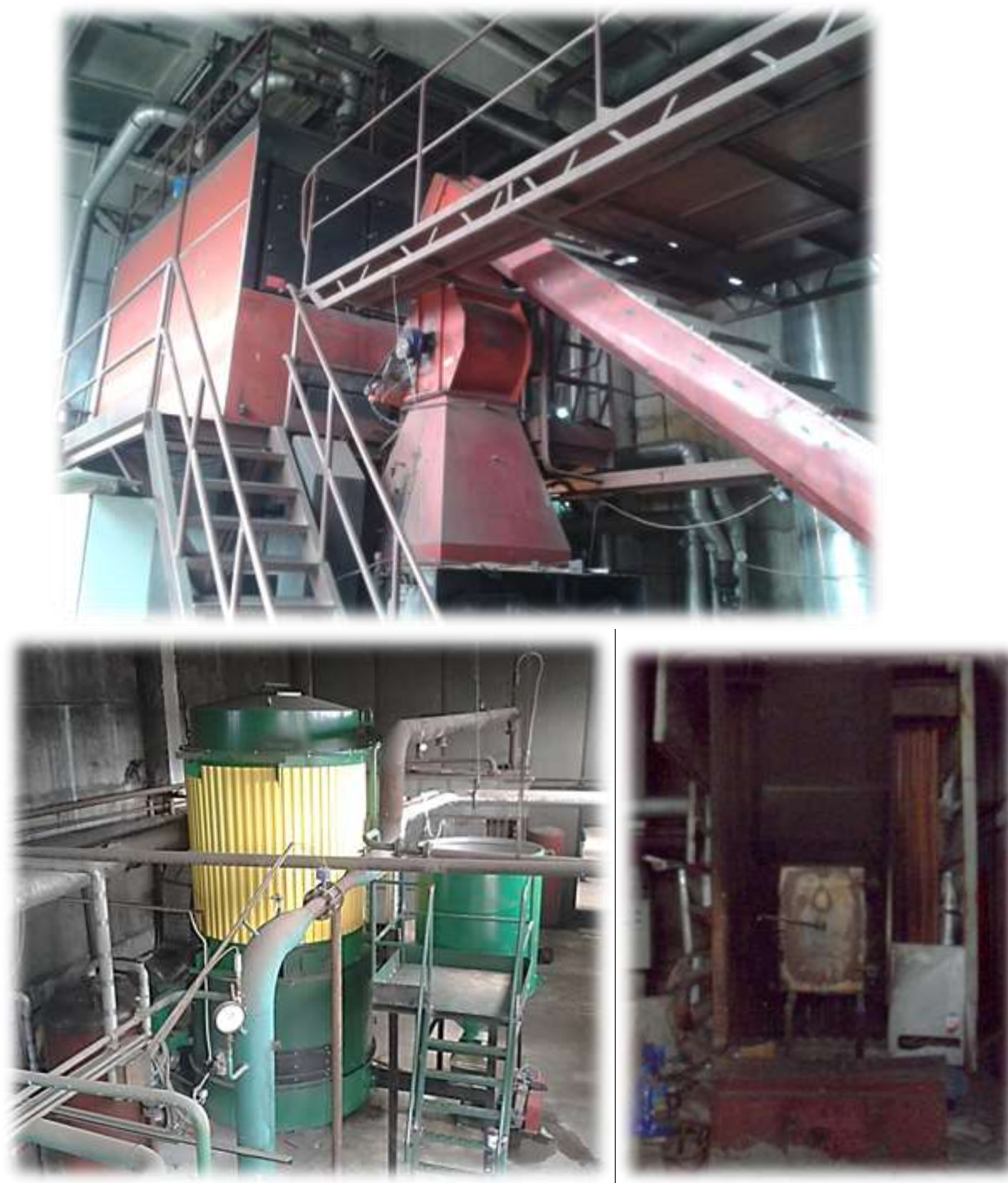
Рисунок 1.2.1.2 Основное оборудование котельной.
