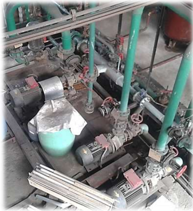
Рисунок 1.2.1.3 Насосное оборудование котельной.
