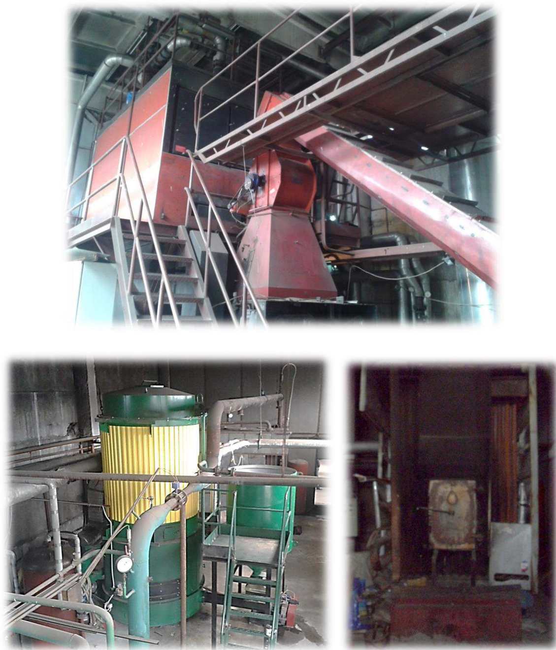
Рисунок 2.1.2.1.2 Основное оборудование котельной.
