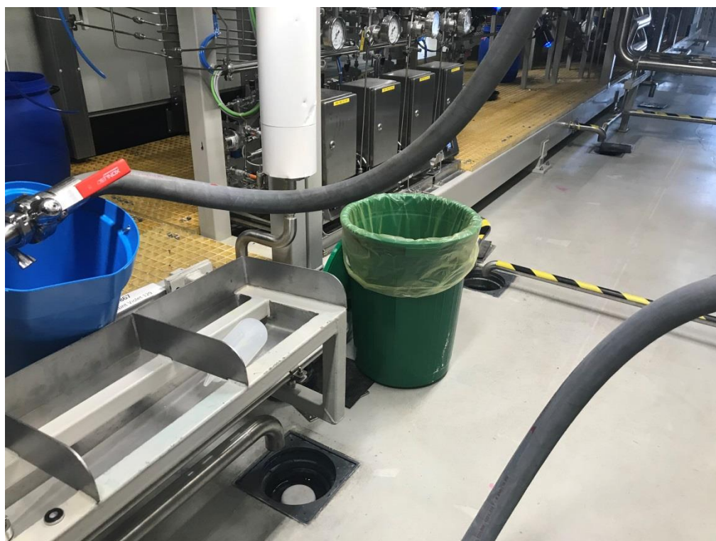
Фото10. Система сбора сточной воды из производственного цеха
