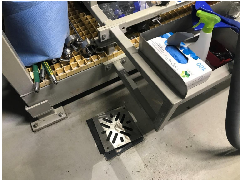
Фото 9. Система сбора сточной воды из производственного цеха
