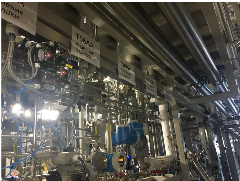
Фото 4. Оборудование ООО «ВеллРус», расположенное в цехе по производству жидких моющих средств
